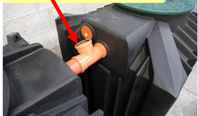
Ventilation haute entre la FTE et le filtre
