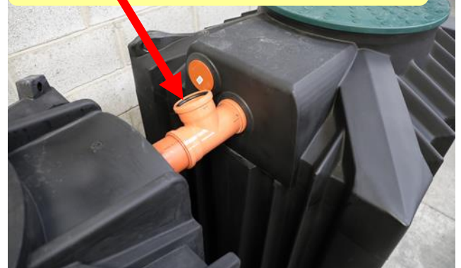
Ventilation haute entre la FTE N°2 et le filtre
